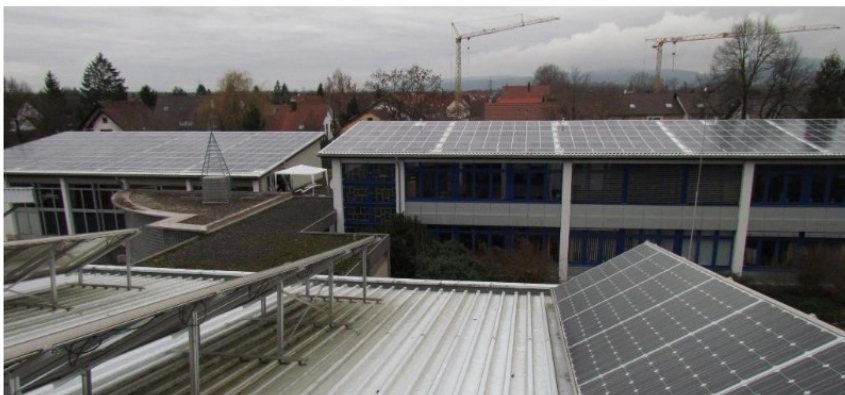
Abbildung 3 – PV-Anlage der BEG March auf den Dächern der Gemeinschaftsschule March (Quelle: BürgerEnergiegenossenschaft March eG, 2019)
